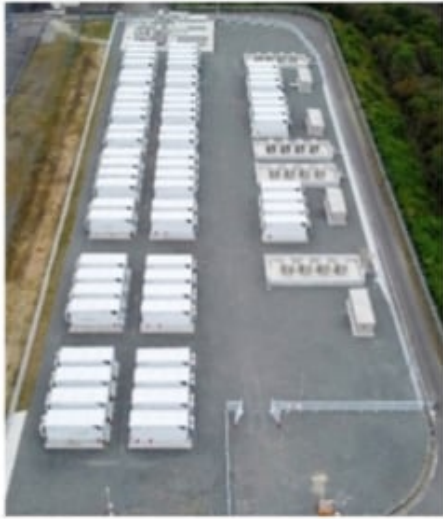
「紀の川蓄電所」全景
