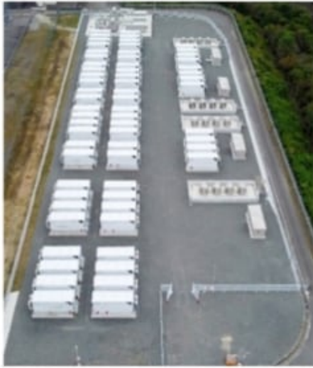
「紀の川蓄電所」全景
