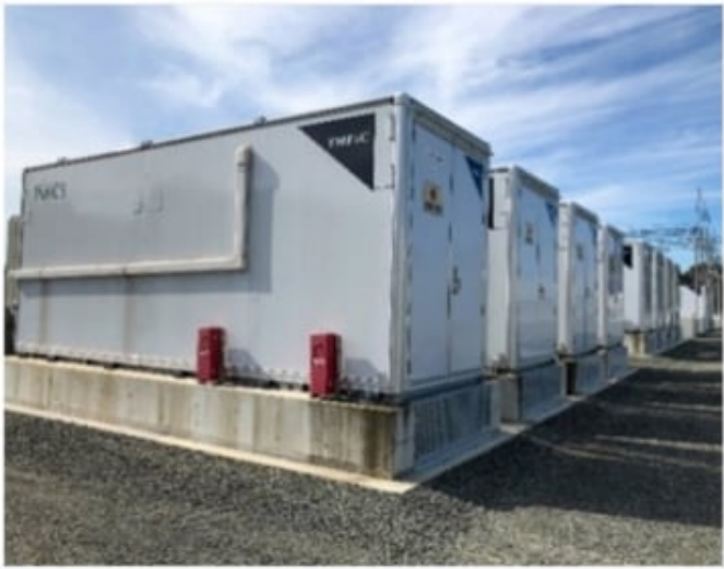
蓄電池コンテナ
