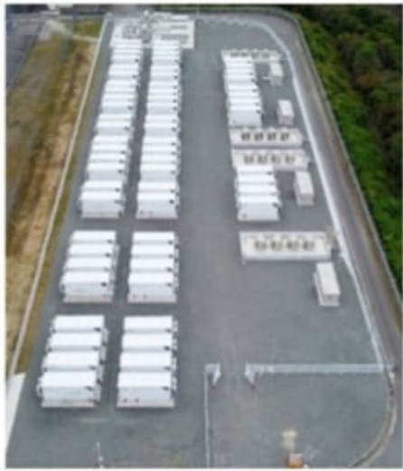
「紀の川蓄電所」全景
